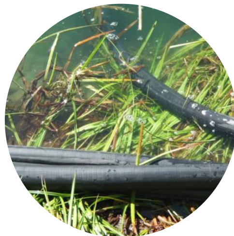
Tuyau Torpedo dans un étang reliant des lignes de Tuayu Bulles® et le compresseur.
